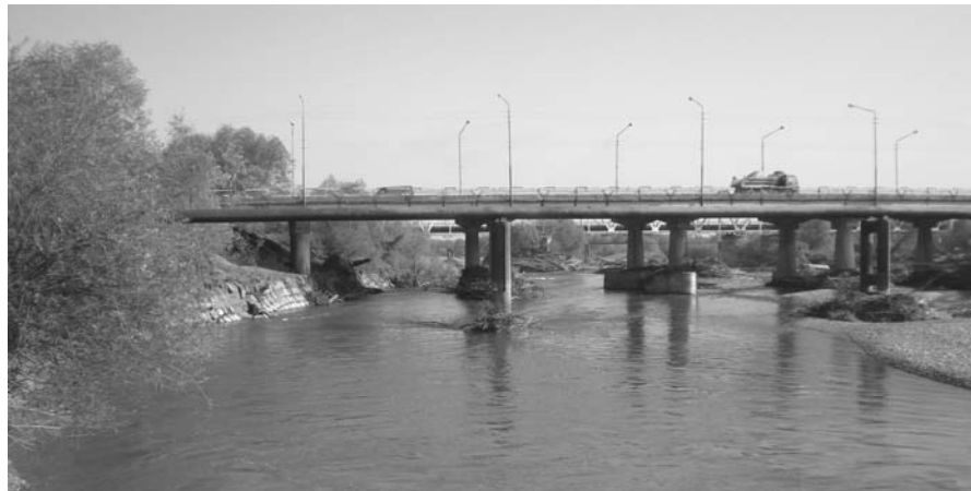
Рис. 5. Розмивання основи під опорами автомобільного мосту
