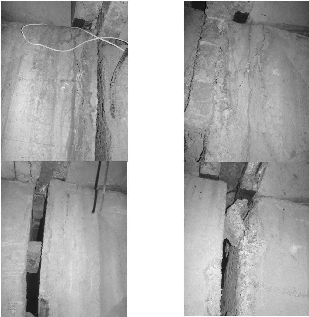
Рис. 1. Руйнування балок покриття прольотом 12 м в опорній зоні з утворенням аварійних тріщин та сколюванням бетону
