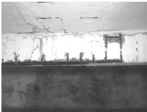
Рис. 1. Пошкодження центрального несучого ригеля
