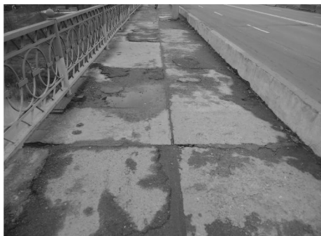
Рис. 1. Відсутність покриття та гідроізоляції на тротуарах
