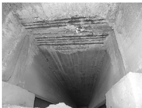
Рис. 3. Пошкодження захисного шару бетону, корозія арматури плити
