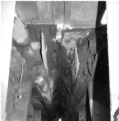
Рис. 1. Пошкодження елементів деформційних швів
